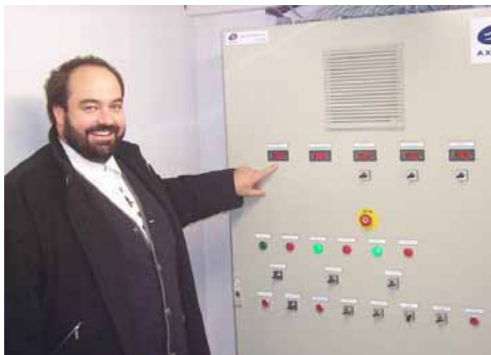
Bild 7 Die geplanten Temperaturen werden erreicht
