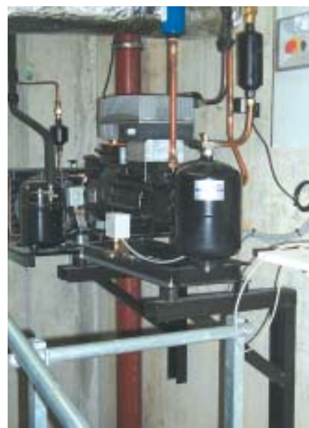
Bild 6: Wandmontage eines FU-geregelten Verdichtersatzes mit massiver Konsole
