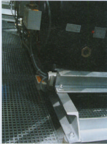
Bild 4 + 5: Verbundanlage mit 2 Drehzahl-geregelten Verdichtern, Schallpegel unter 50 dB bei 1 m Abstand
