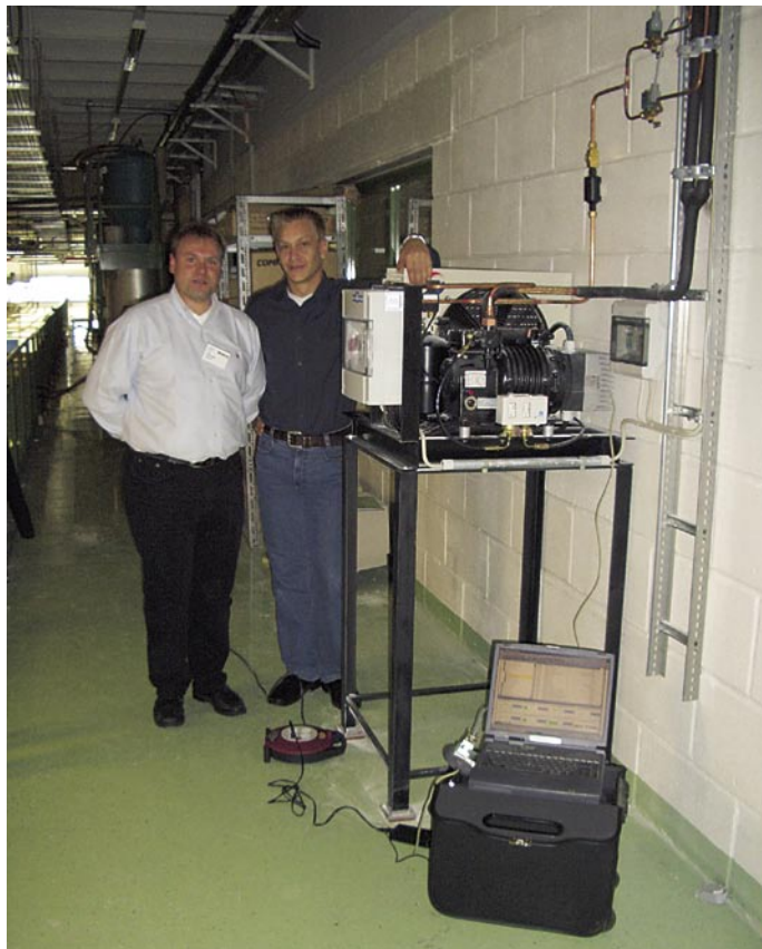
Bild 5 Diplom-Ingenieur Friedrich Schweikle (v.l.) und Jörg Ferl vom Kühldeckenhersteller Thermolution neben dem Goeldner-Motion-Verflüssigungssatz
