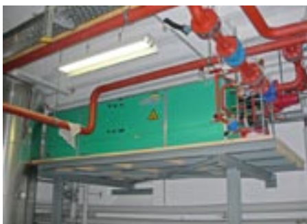
Monoblockgerät mit der eingebauten Wärmepumpe. Gut sichtbar die Revisionstüranordnung zur Bildung einer Wanne
