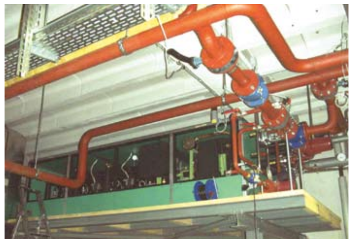
Bild 6: Die Wärmepumpe auf dem Podest zur erdgleichen Aufstellung im Untergeschoss, Gehäuse geöffnet
