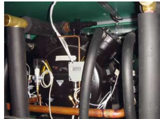
Bild 7: Goeldner-Propan-Verdichter im eingebauten Zustand
