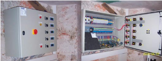
Der vorgefertigte Schaltkasten
