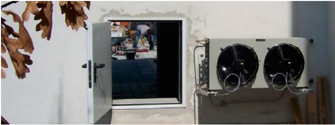
Verflüssiger außerhalb des Maschinenraums
