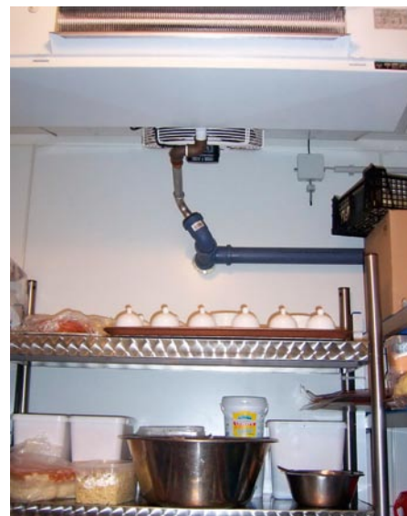
Einsicht in eine der vier Kühlzellen
