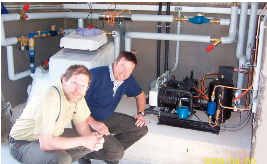
Das Kälteaggregat mit den beiden Verdichtern NK+TK und dem Zubehör (links Karl Huber, HKT; rechts Herr Rieger, Rieger Kälteanlagenbau GmbH)
