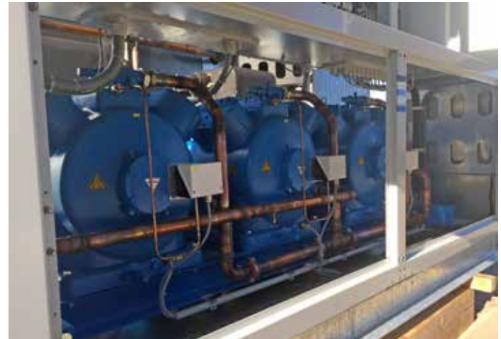
Bild 2: Das Maschinengehäuse von innen mit den R290-Goeldner-4Zyl.-Hubkolbenverdichtern
